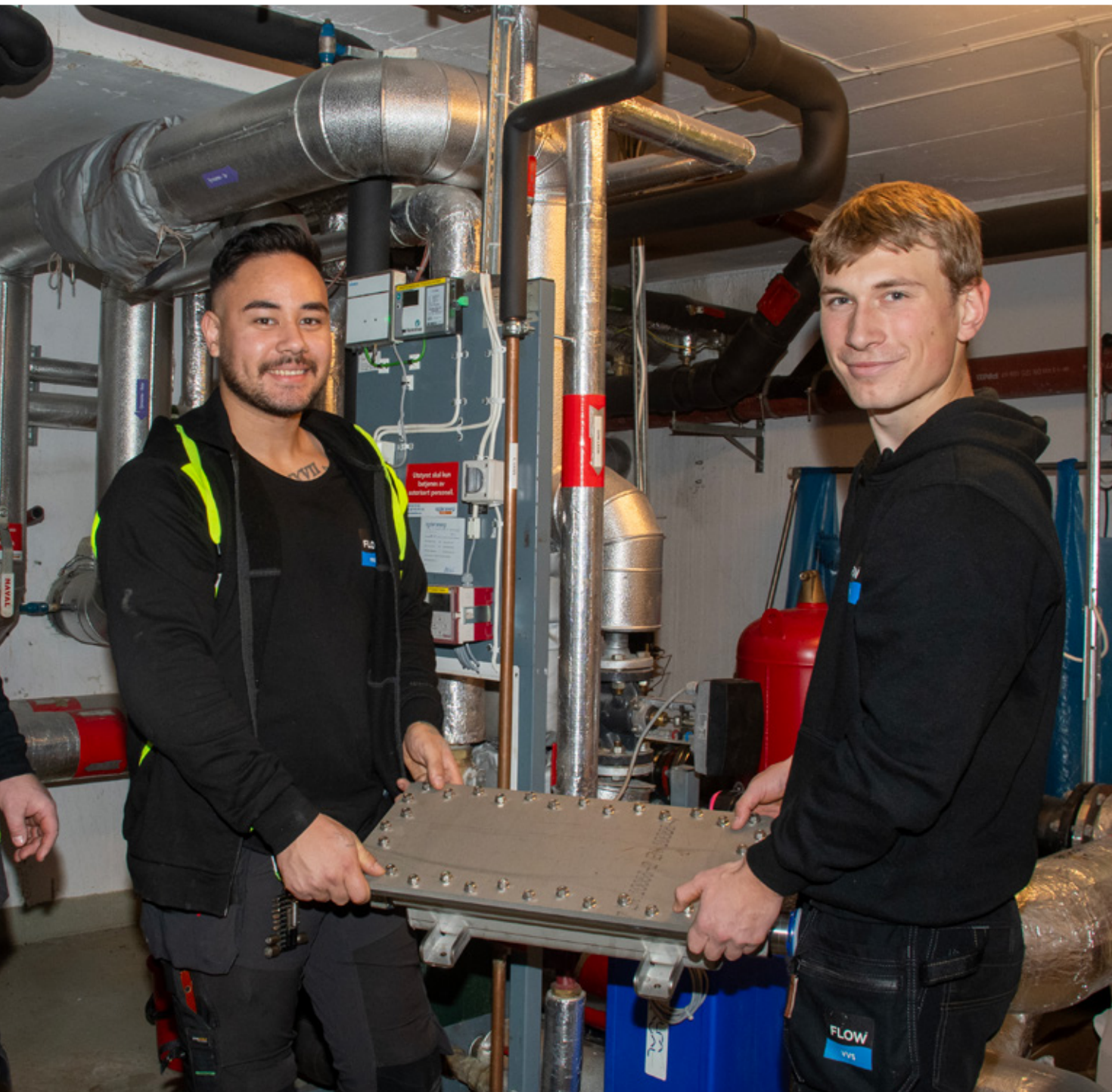
⬆ – Systemet består av en styringsenhet og én eller flere prosessceller, som vi monterer på hovedvannrøret, sier (fra venstre) Svein Roger Samuelsen, Tom Edward Hefner og Stian Myrvang fra Flow VVS.
