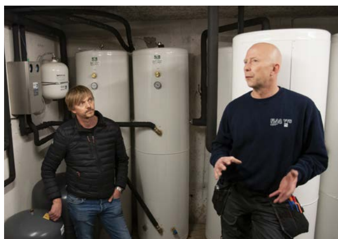
⤴ Timenes og Olsen i det tekniske rommet i kjelleren.
