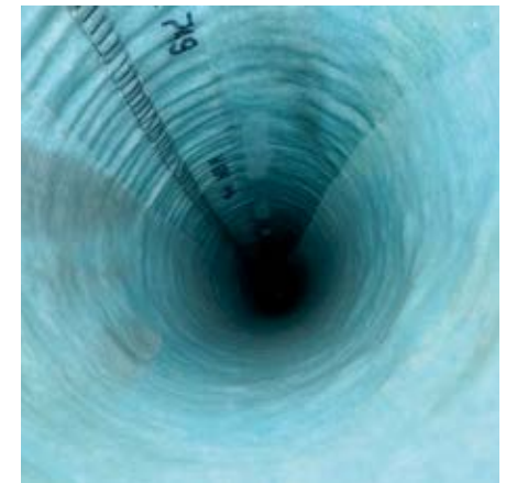
■ Et avløpsrør etter rørfornyning med strømpe.
