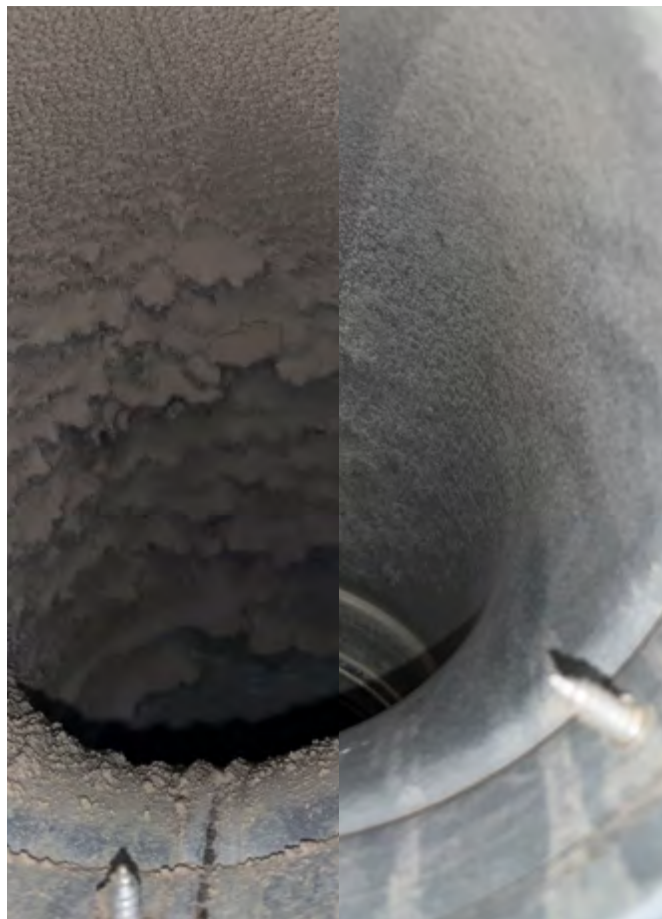
⤴ - Ventilasjonskanaler før og etter rens.
