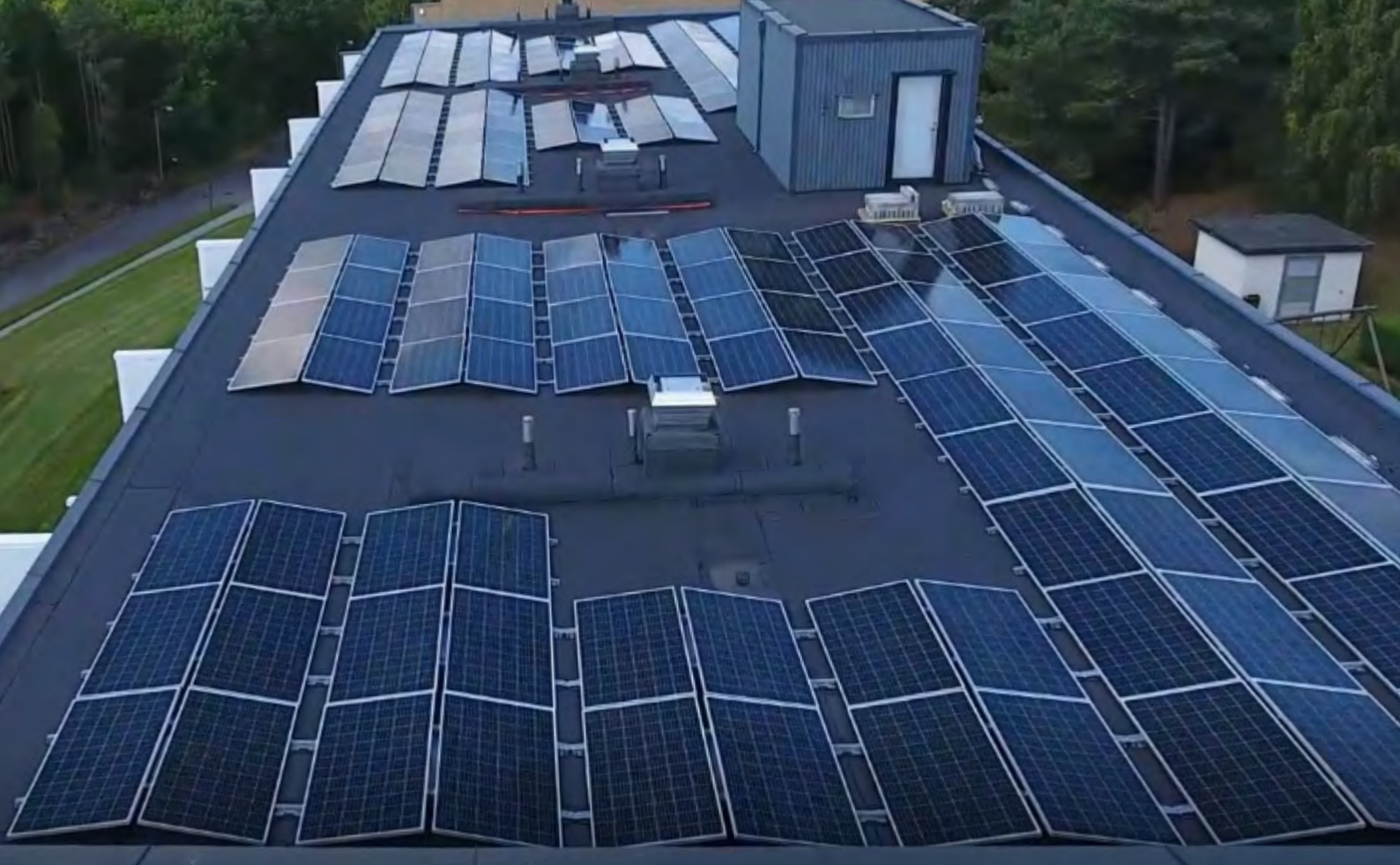
Bilde av Solceller fra Vigvoll Terrasse. Foto: Tratec
