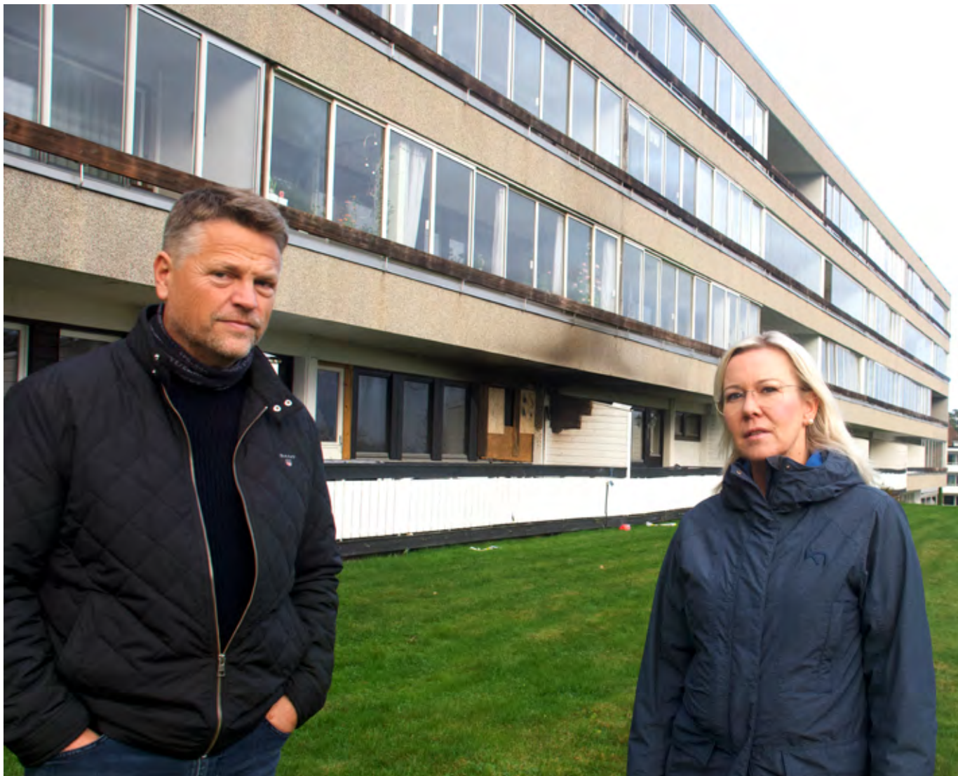
⤴ Styreleder i Slettheiveien 61 Sameiet, Åsne-Louise Halvorsen, og bygningsingeniør hos Sørlandet Boligbyggelag, Lars Ørjan Vegusdal, utenfor leiligheten som ble totalskadet under brannen.
