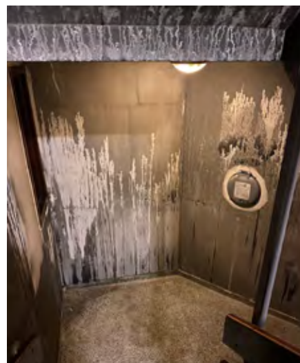
⌘ Trappegangen er nedsotet etter brannen.
