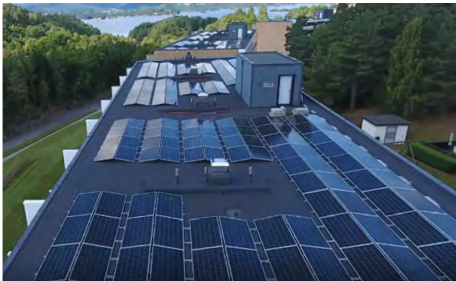
⬆ Til sammen er det montert 816 solceller på fem tak. (Foto: Tratec)
