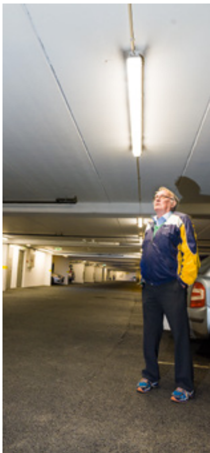
Guldmand Brygge sparer tusenvis av kroner hvert år på å bytte til ledlys i parkeringsanlegget. To år på rad har de fått miljømidler fra Sørlandet Boligbyggelag til prosjektet.
