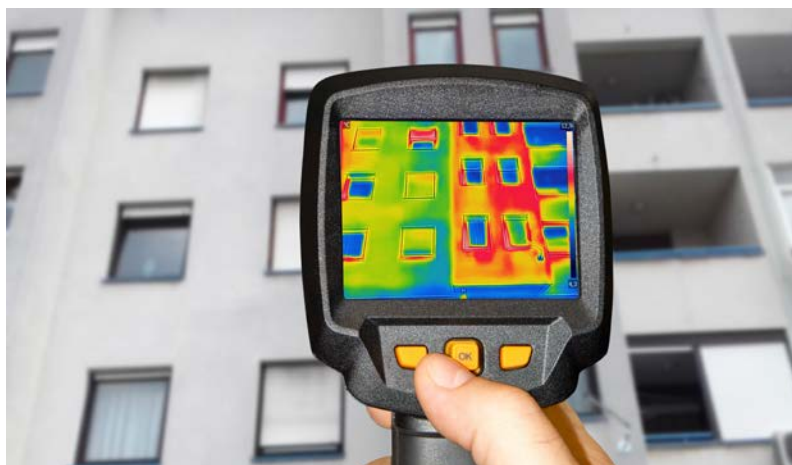
Termografien viser at her er det behov for etterisolering. Foto: Shutterstock
