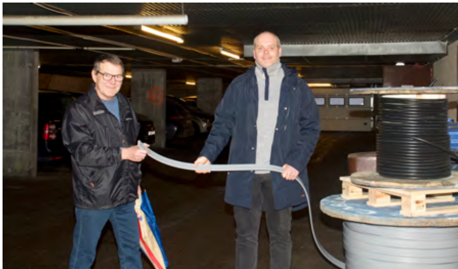
➤ Styreleder Dag Berthrand Danielsen (t.v.) og Øystein Støle hos Oneco er klare for installering av ladestasjoner.
