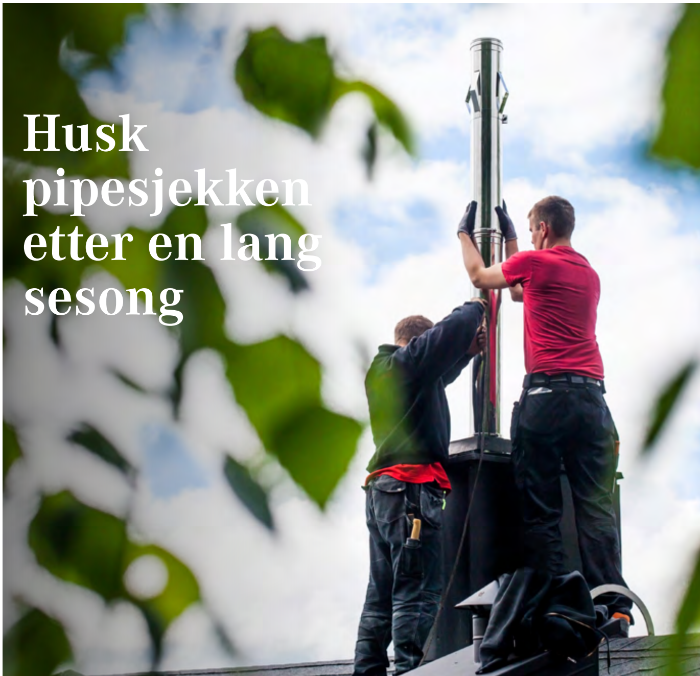
⬆ Piperehabilitering kan være løsningen dersom det er store skader på pipa. (Foto: Varmefag)
