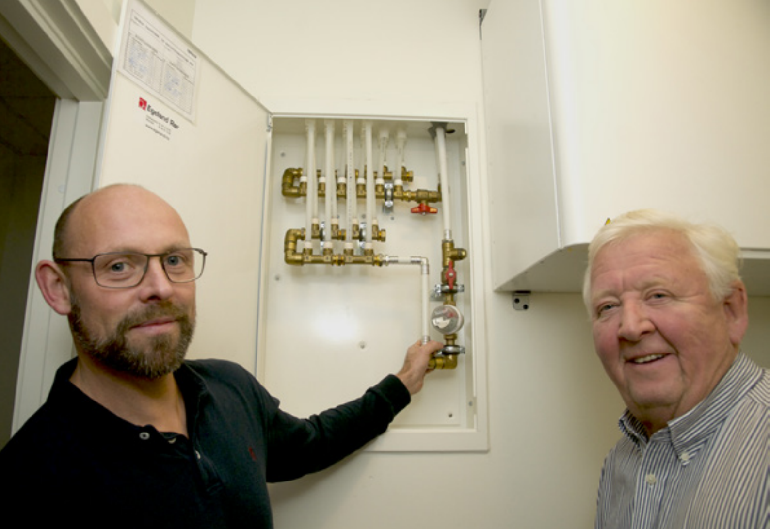
⤴ Geir Blomstadli i Techem (t.v) og Ole Nygaard i Sameiet Tangen Ytterst viser kontrollanlegget for fjernvarmeanlegget – med den automatiske måleren.
