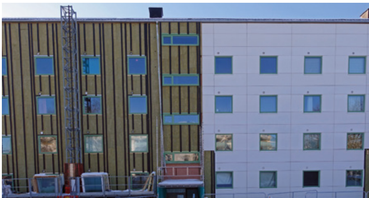
Kanalfri ventilasjonsløsning med Lunos-ventilatorer gir vesentlig mindre inngrep og trenger mindre plass enn tradisjonell balansert ventilasjon, poengterer arkitekt Per Wigum.
