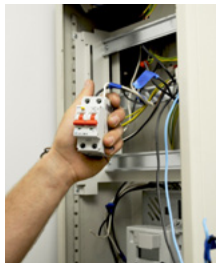
⤴ Gamle sikringsskap bør oppgraderes med nye automatsikringer med jordfeilbryter.
