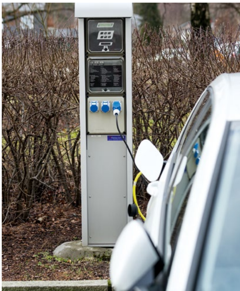
Stadig flere får elbil, og borettslag må legge til rette for lading.
