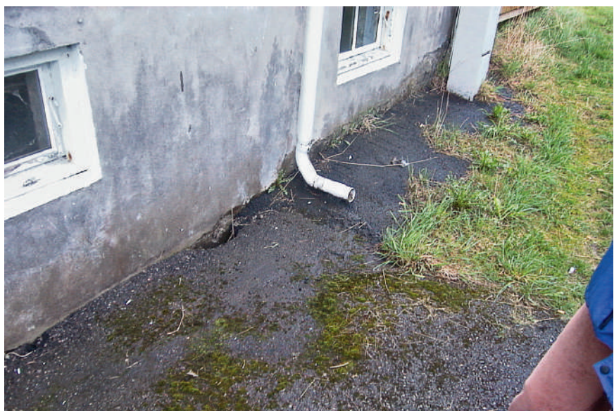
Dette er en dårlig løsning; et nedløpsrør med et utkast like ved en yttervegg. Ytterveggen har ingen grunnmursplast. Det er et stort hull i bakken inntil veggen hvor vannet kan renne ned og fukte betong-/kjellervegg.
