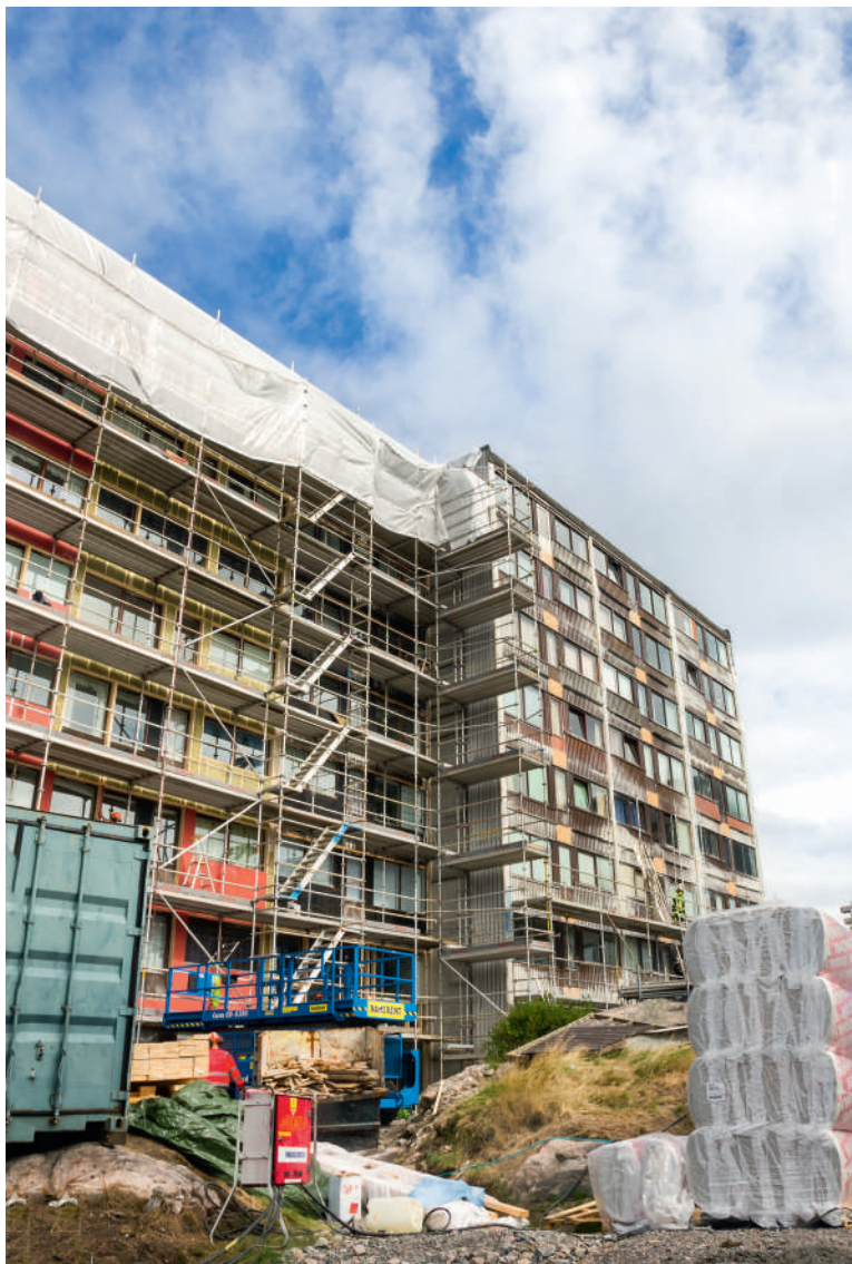
Bygging og rehabiliteringsarbeider av boligblokker gjøres med utgangspunkt i strenge lover og regler som skal hindre at en eventuell brann sprer seg. Arkivfoto
