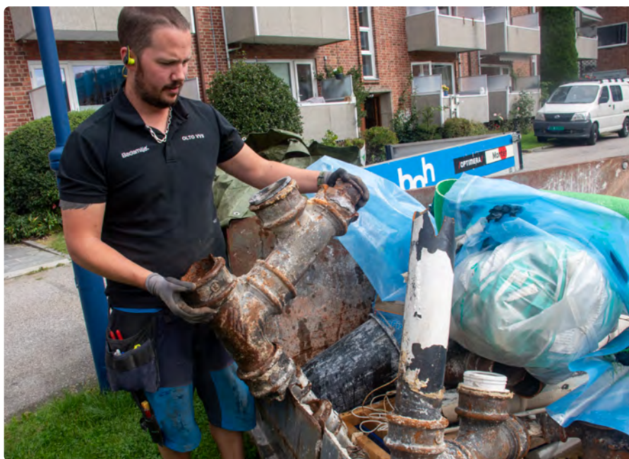
Prosjektansvarlig Kristian Berg med de gjennomrustne rørene som nå er skiftet ut.
