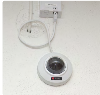
Kamera på garasjeveggen.
