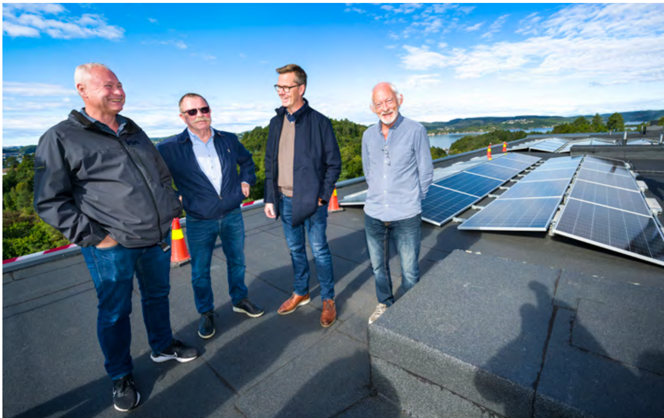
» Det var god stemning på taket da solcelleanlegget til Vigvoll Terrasse Borettslag ble offisielt åpnet. Fra venstre: Styreleder Roy Georg Abrahamsen, Endre Nodeland fra solcellekomiteen, adm. dir. i Sørlandet Boligbyggelag, Kristian Råmunddal og Eigil Sørleie fra solcellekomiteen.
