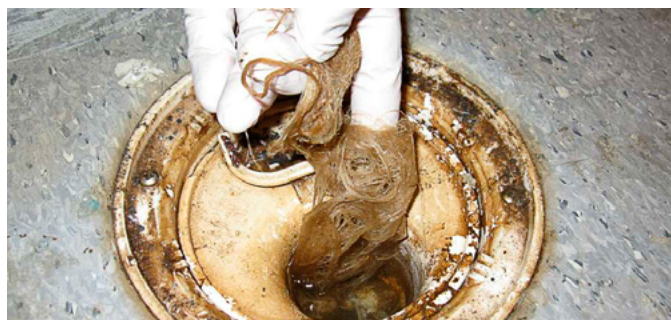
Tette sluk er en av årsakene til store vannskader. Foto: Sintef Byggforsk
