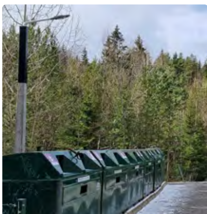
⬆ En soldrevet lysmast fra BTG på Birkeland har nok energi til å lyse minst 90 dager uten solskinn.
