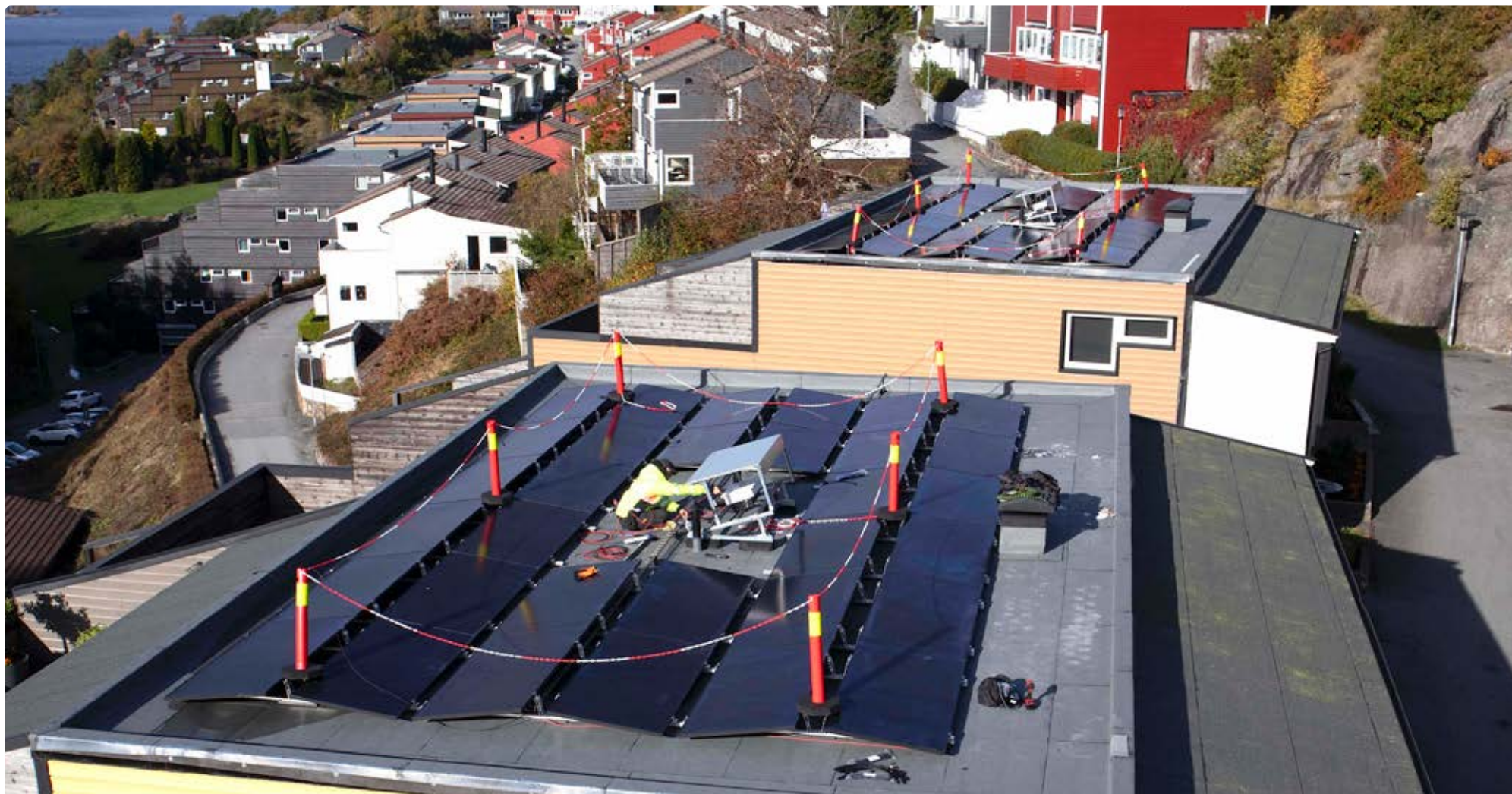
☑ Solcelleanlegget på terrassetakene i Brattbakken Borettslag skal kunne produsere 200 000 kilowattimer strøm årlig. (Foto: Line Sangvik, Skanbatt)
