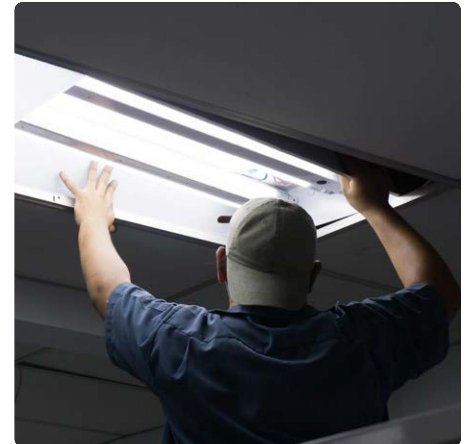
En moderne led-armatur har en levetid på mellom 50 000 og 100 000 timer, noe som betyr at du kan ha vedlikeholdsfri belysning i fra 10 til 30 år. Det er bare å bytte ut de gamle lysstoffrørene! (Foto: Shutterstock)
