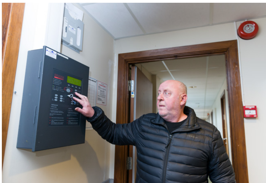
Branntavlen i inngangspartiet viser hvor i blokka en alarm er utløst.
